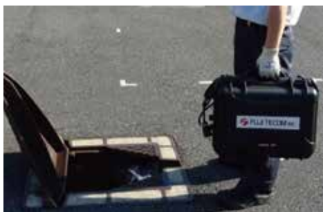
監視盤が設置できない場所でも※
