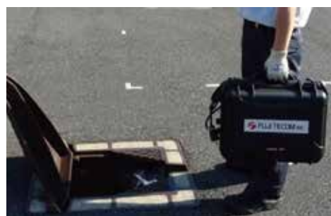
監視盤が設置できない場所でも※
